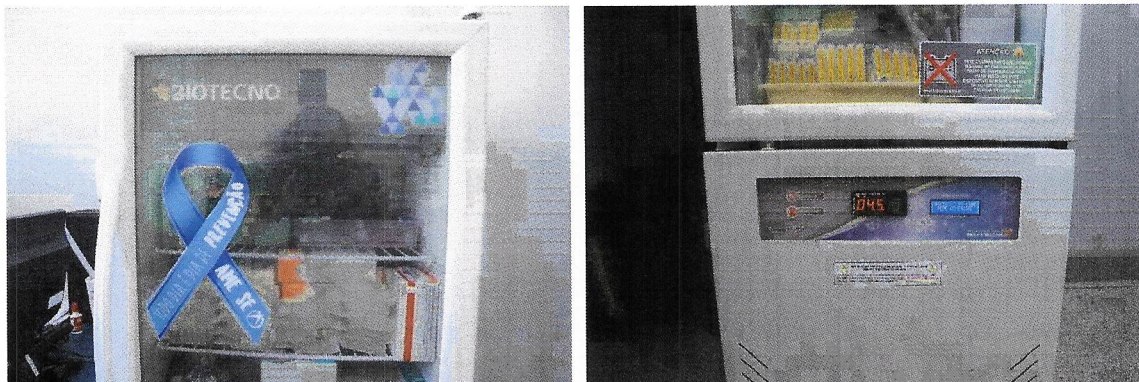
Vista da câmara fria que armazena as vacinas do município de Nova Olinda – TO
