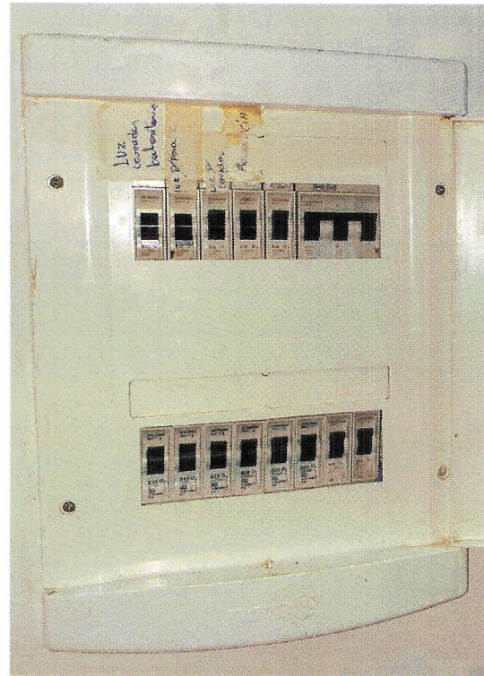
Quadro de distribuição de energia da Unidade
