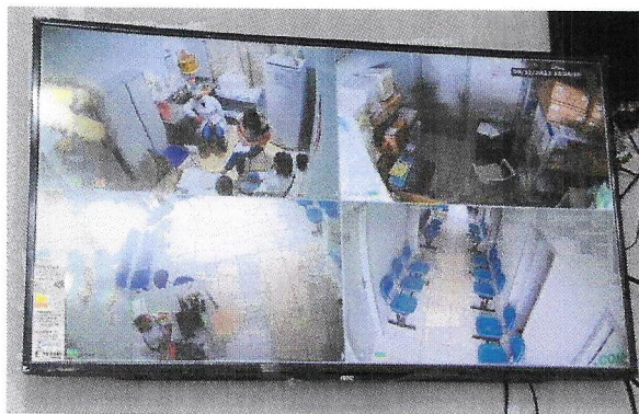
Sistema de monitoramento de câmeras da UBS
