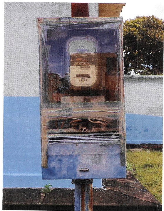
Padrão de entrada de energia da Unidade
