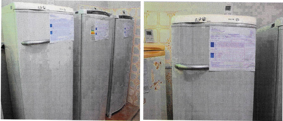
Vista externa dos refrigeradores que armazenam vacinas no município de Formoso do Araguaia – TO
