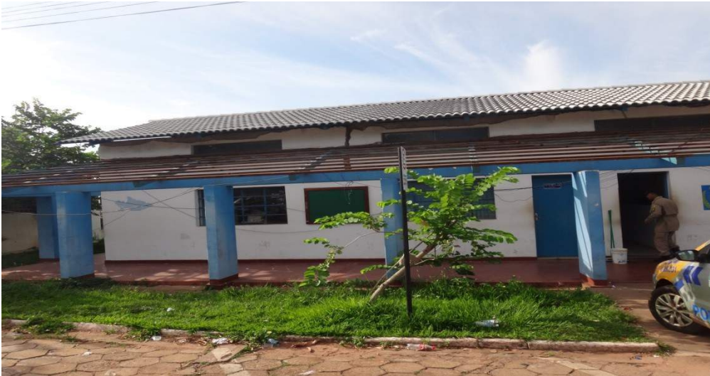
Imagem 17: Fiação exposta (SIOP)
