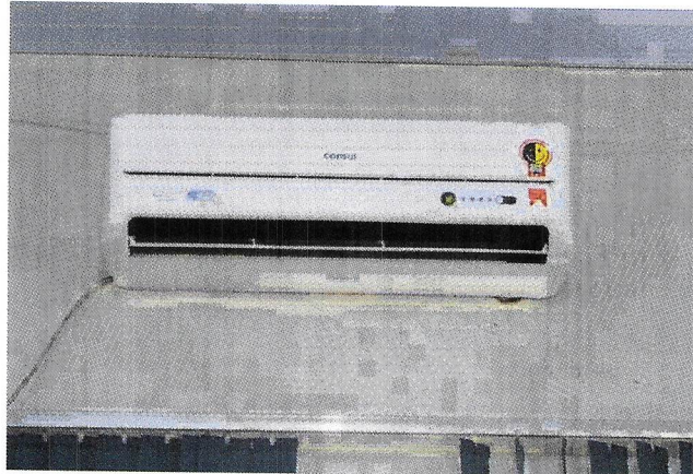
Aparelho de ar condicionado da Central de Armazenamento de Vacinas de Miracema
