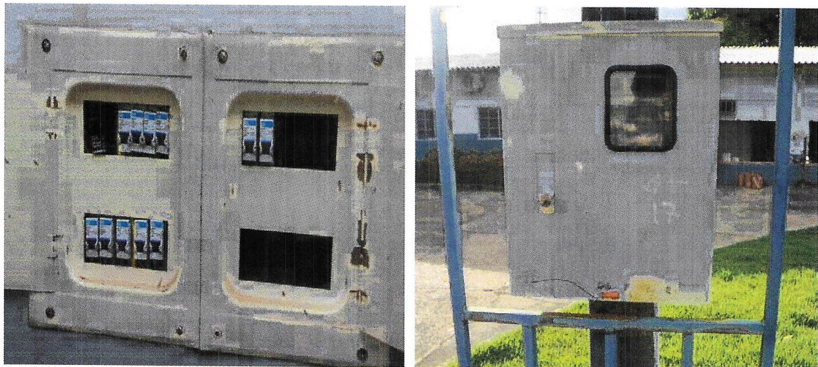
Quadro de distribuição e padrão de energia da unidade de saúde
