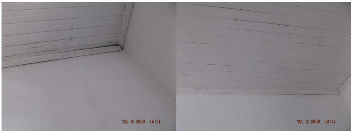
Forro Delegacia de Santa Fé do Araguaia em péssimo estado.
