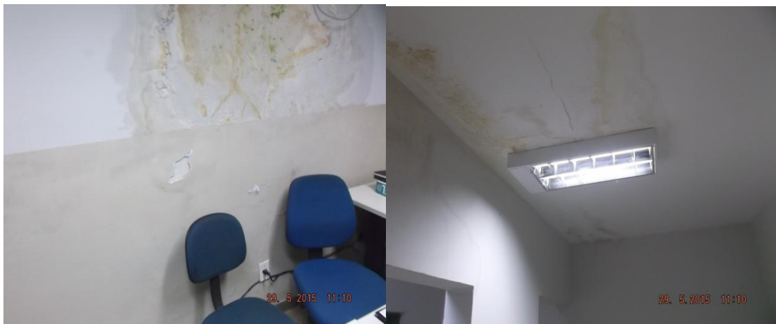
Infiltração nas paredes da Central de Flagrantes
