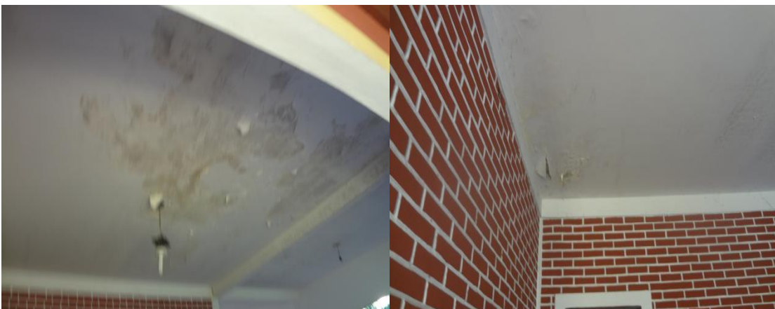
Infiltração no prédio da DEIC de Araguaína, inclusive no teto
