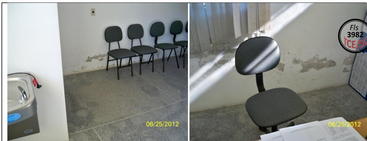
Foto 100_5004: Umidade na parede e no chão da sala de reuniões.
